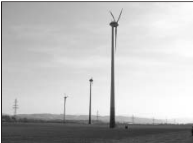
□ Větrné elektrárny u St. Pölten o výkonu 0,6 MW.
