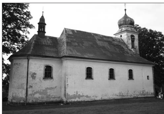
☐ Kostel Nejsvětější Trojice v Říčkách čeká nátěr střechy věže.
